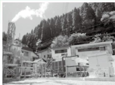
杖立温泉熱バイナリー発電所
